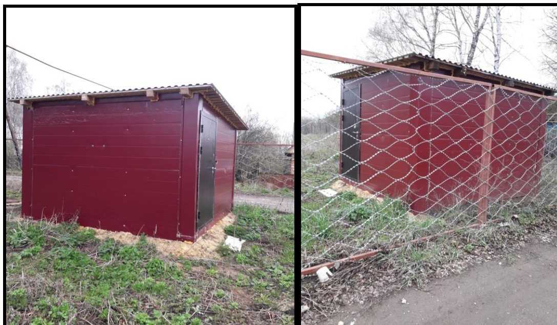
Насосная станция в с. Гранки
